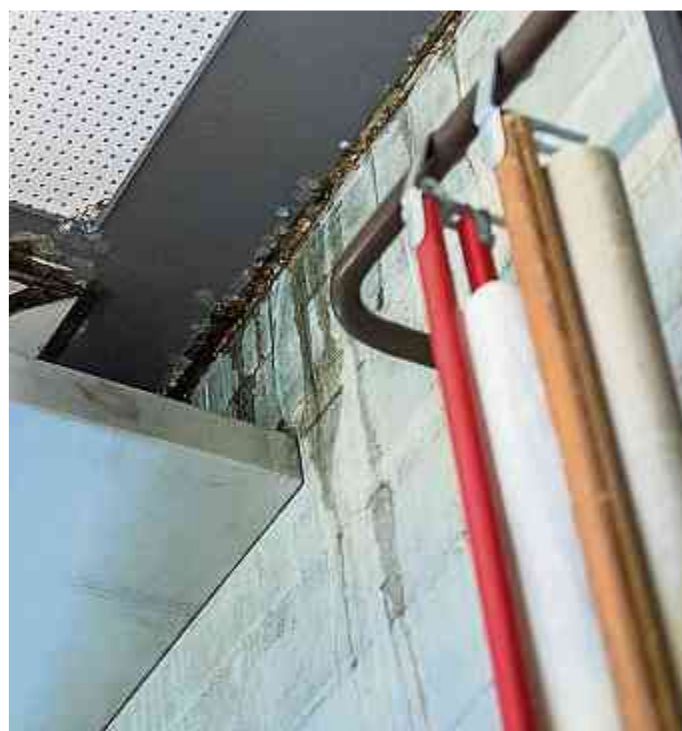
Das Regenwasser drückt durch die Decke in die Schulzimmer.
