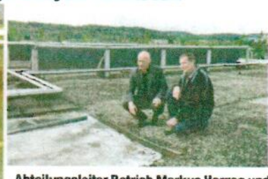
Abteilungsleiter Betrieb Markus Herzog und Hauswart Walter Meier erläuterten die Probleme des Flachdachs
